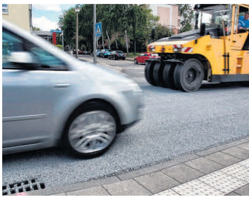
Blick auf den neuen Überweg in Südwest: Anders als vermutet, wurden die neuen Zebrastreifen nicht wieder abgefräst.
